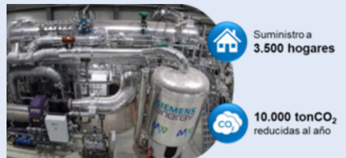
Figura 37. Bomba de calor de Mannheim, Alemania
